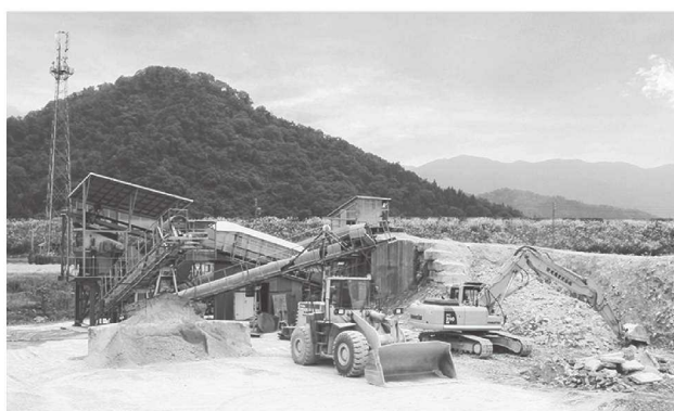
破碎プラント
